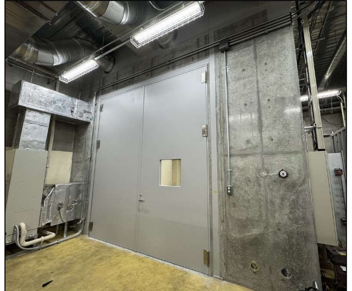
リチウムイオン電池試験室
