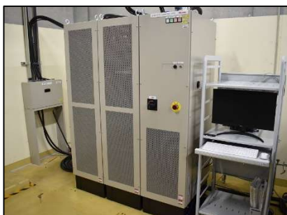
充放電試験装置
