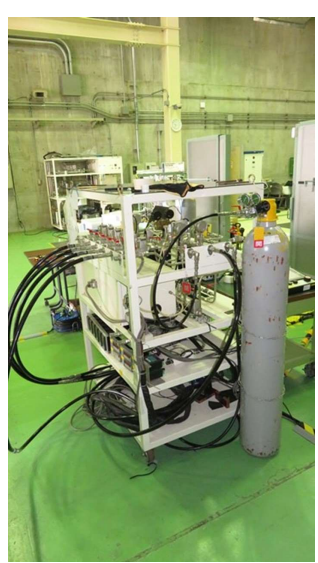
水素供給装置
