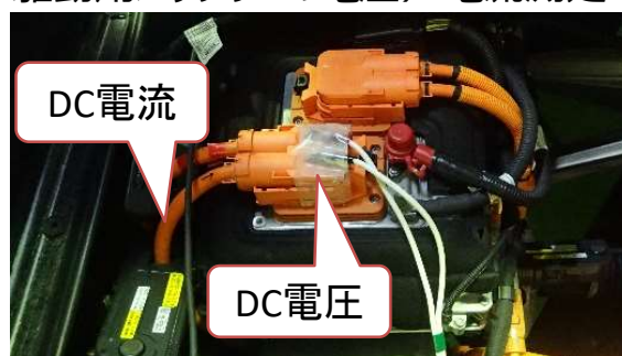
駆動用バッテリーの電圧／電流測定
