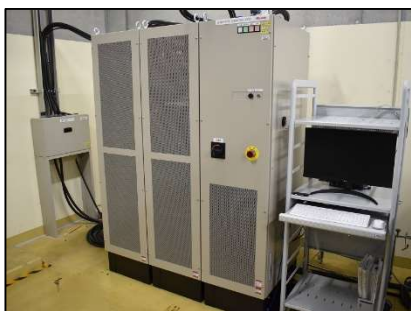
充放電試験装置
