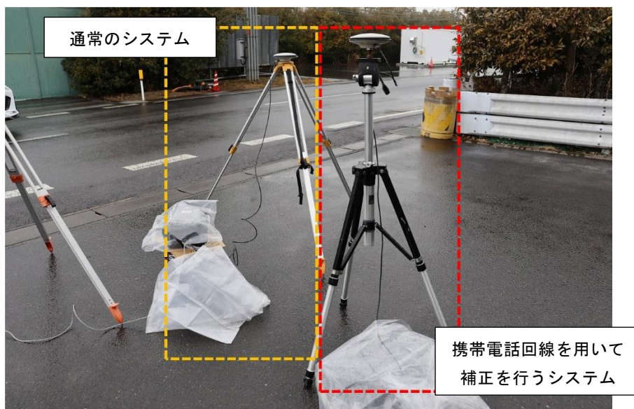
図3 設置したGPS RTK基地局
