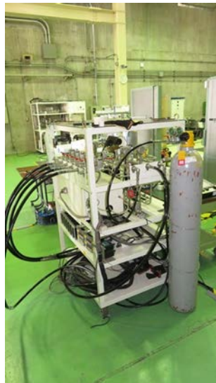
水素供給装置
