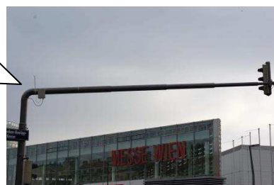
図表 7-9 信号機に設置の路側機
