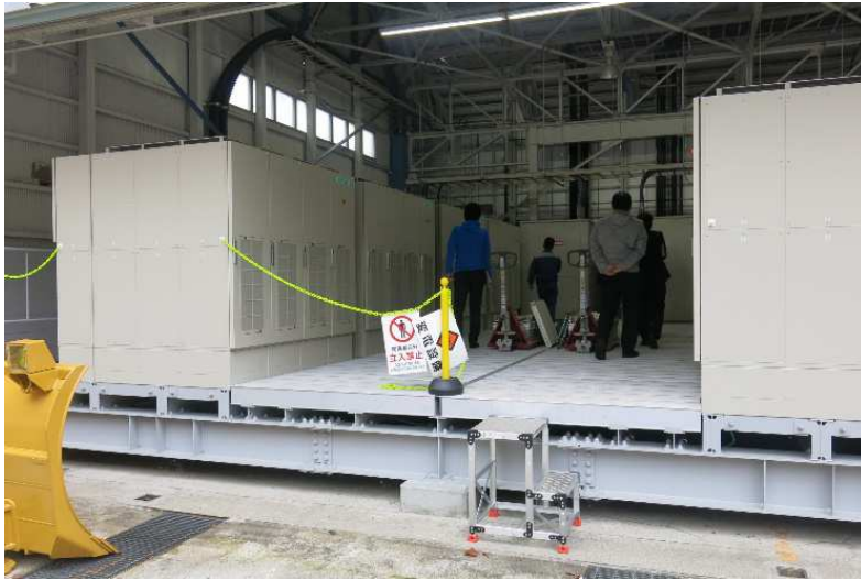
図 13 パンタグラフ用充電器 8 基
