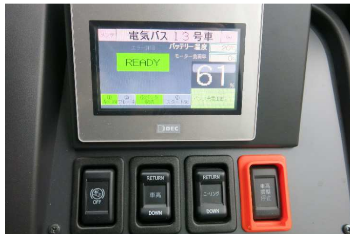
図10 バッテリーメータ（温度、SOC）
