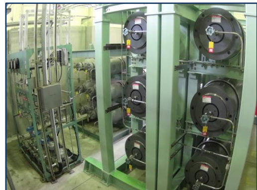
水素ガス蓄圧容器 (2448L)
