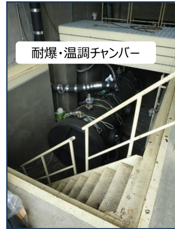
地下ピット（試験時）
