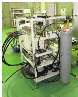
水素供給装置
