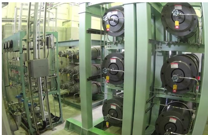
図 28 圧縮水素試験設備の蓄圧容器
