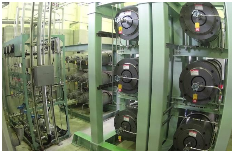
図 28 圧縮水素試験設備の蓄圧容器
