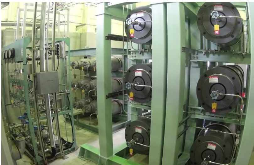
図27 圧縮水素試験設備の蓄圧容器
