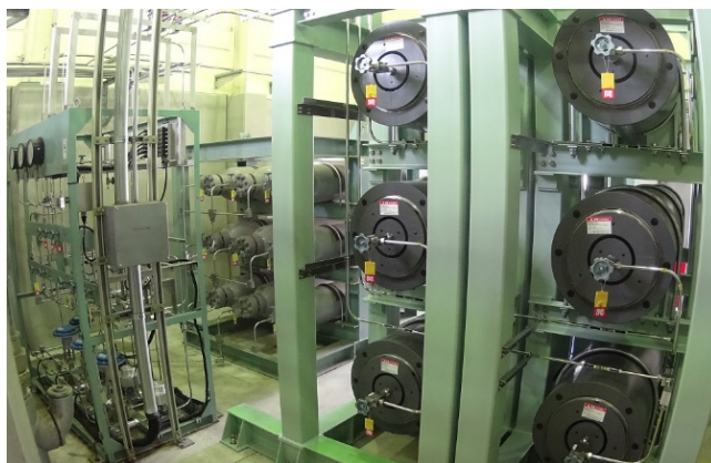
図26 圧縮水素試験設備の蓄圧容器
